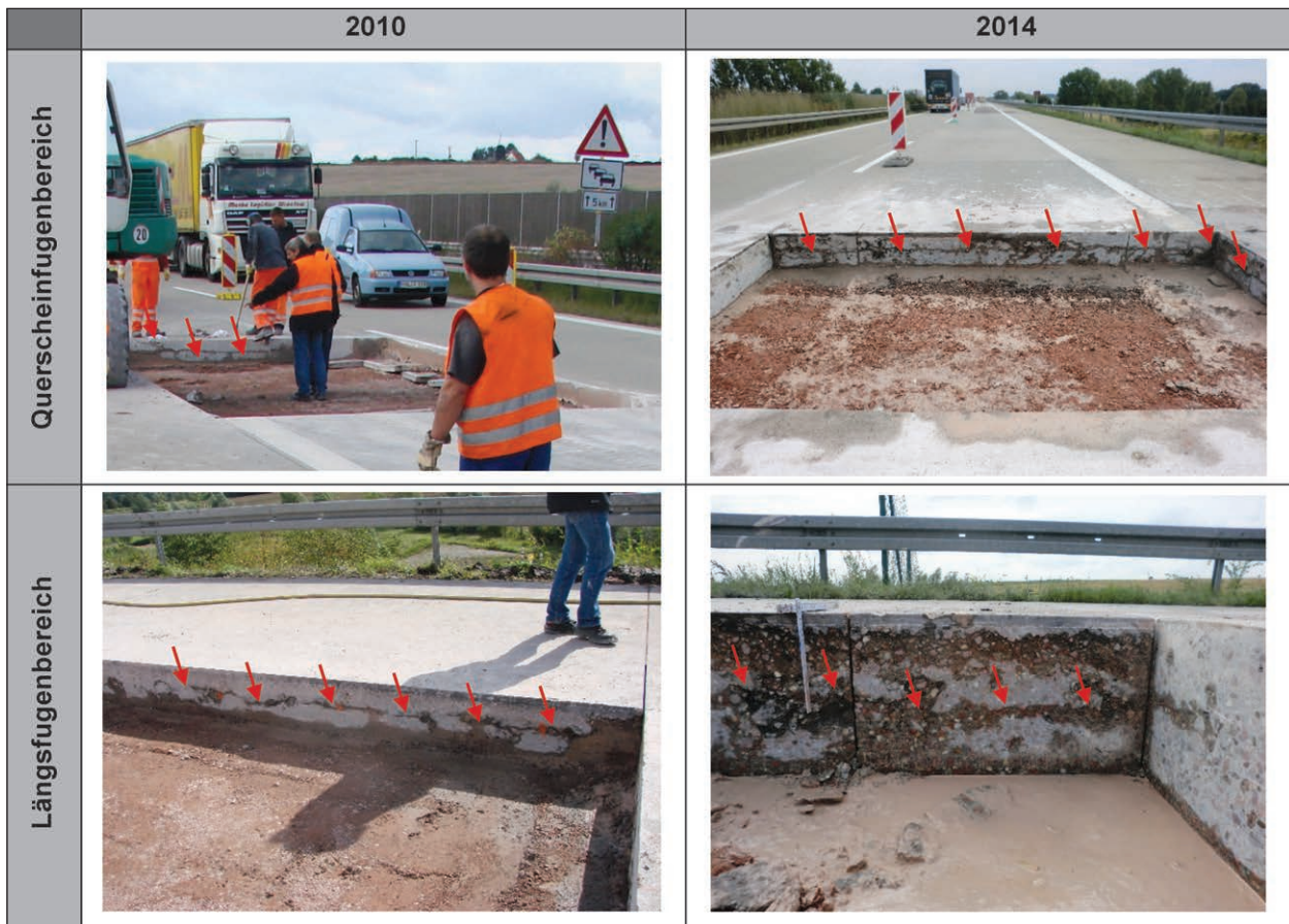
Bild 26: Fotodokumentation zur horizontalen Rissbildung im Bereich der Querschnitts- und Längsfugen in der Ebene der Dübel und Anker
