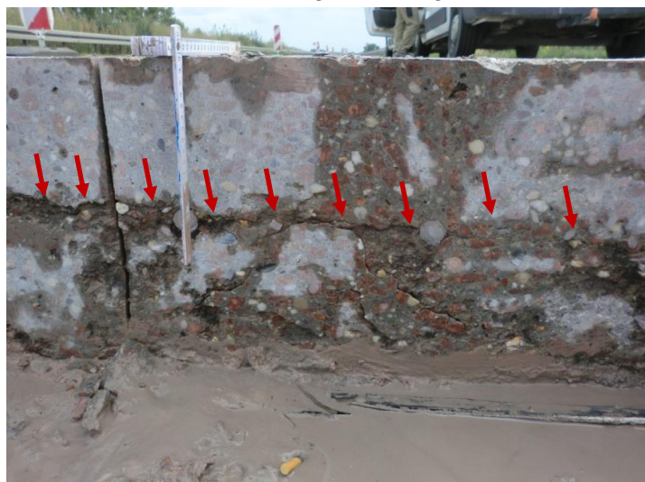
Detailbild des durchgehenden Horizontalrisses in Dübelebene
