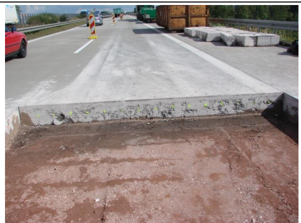
f. Ansicht der Querscheifuge mit durchtrennten Stabdübeln
