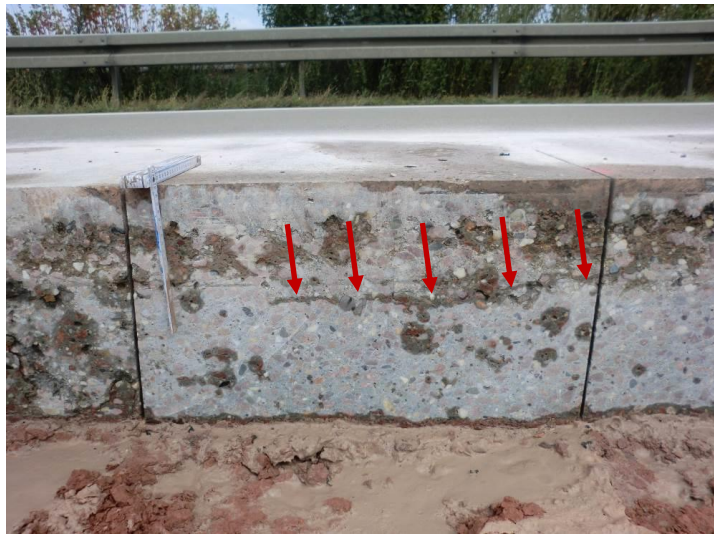
Horizontalriss im Bereich der Längsfuge in der Höhe der Ankerebene
