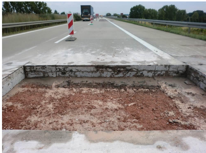
Horizontalrissbildung in Dübelebene bei Querscheinfuge und Fugenkreuz
