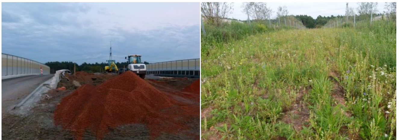
Bilder 5 und 6: Einsatz einer vegetationstechnischen Bodenverbesserungsmaßnahme mit Ziegelbruch bei der Grünbrücke A 14 bei Colbitz – links: während der Bauausführung; rechts: nach der Begrünung
