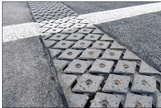
Bild 17: Deutlich erkennbare Asphaltüberhöhung an der Fuge vor der Inbetriebnahme
