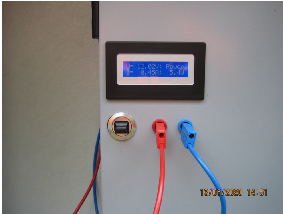
Abbildung 45: Wattmeter im Kabelverzweigerschrank
