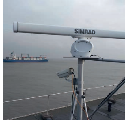
Abb. 6: Die Kamera unterhalb der Radarantenne, hier in Cuxhaven.
