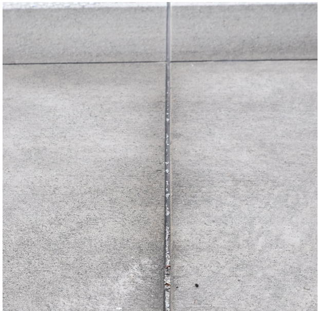
Bild 163: Verschmutzung inkl. Streusalzablagerungen im Standstreifen (Januar 2018, Testfeld 1.2)
