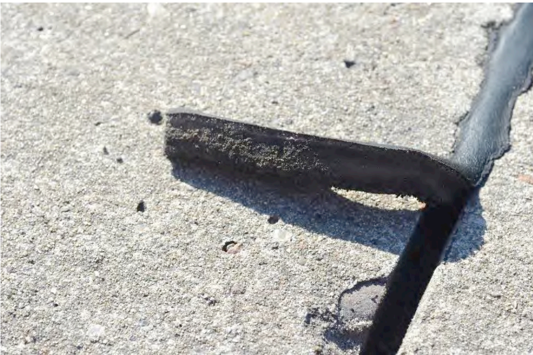
Bild 222: Herausgelöste Fugenmasse (A7)
