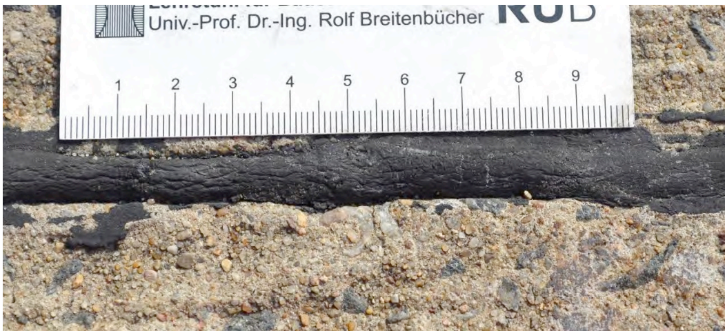
Bild 216: Oberflächlich versprödete Fugenmasse (A24)
