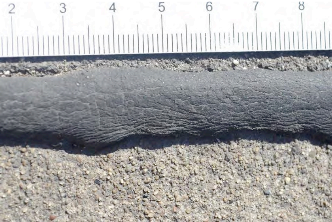
Bild 221: Oberflächlich versprödete Fugenmasse (A7)
