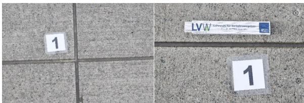
Bild 158: Beispielhafte visuelle Zustandserfassung in Testfeld 1.1 und 1.2 im Oktober 2016
