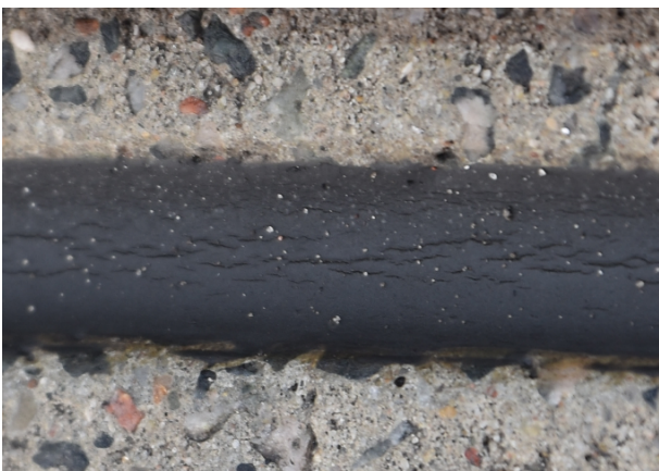
Bild 162: Detailaufnahme von oberflächlichen Rissen der Fugenmasse parallel zur Fugenflanke (Januar 2018, Testfeld 1.1)
