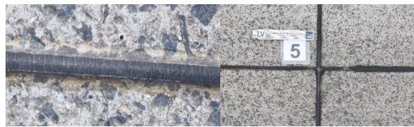
Bild 159: Beispielhafte visuelle Zustandserfassung in Testfeld 2.1 und 2.2 im Oktober 2016
