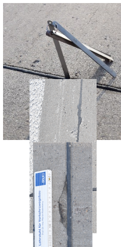
Bild 125: Details des Zustandserfassung A2 – Abschnitt 1
