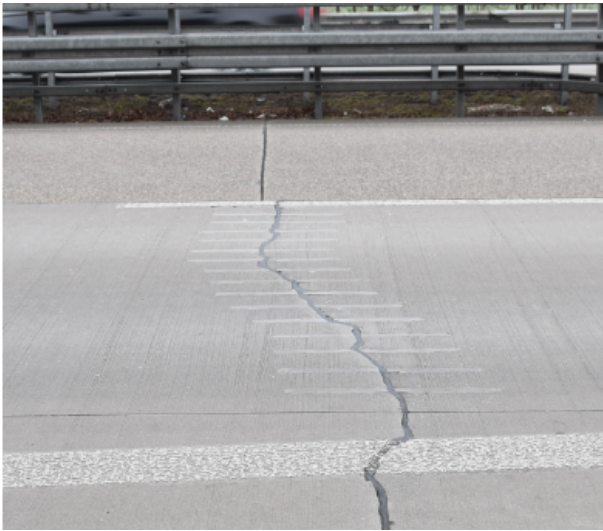
Bild 130: Detail der Zustandserfassung A40 – „wilde“ Risse aufgrund der Plattenlänge von 10 m, trotz stahlfaserbewehrtem Beton
