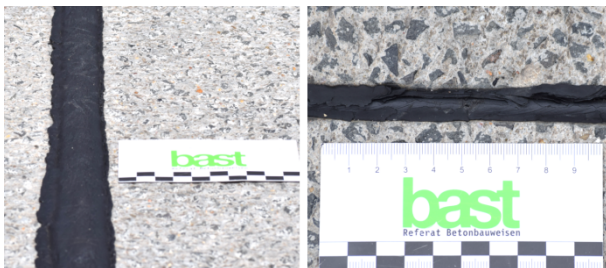
Bild 123: Überbeanspruchung der Fugensysteme A48 (links: heiß verarbeitbare Fugenmasse; rechts: heiß verarbeitbare Fugenmasse)
