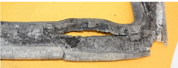
Bild 131: Details des Zustandserfassung A40 – zweilagiger Verguss
