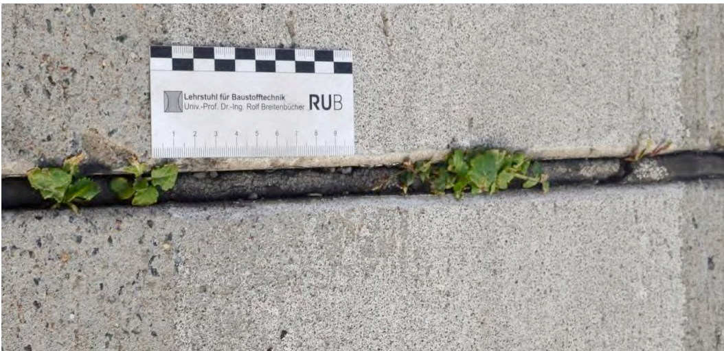
Bild 214: Grasbewuchs an den Fugenflanken (A24)
