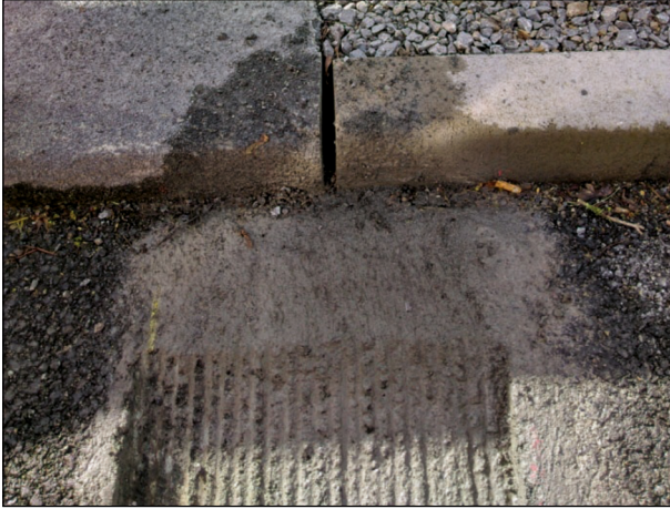
Bild 14: Auslaufen der Fugenmulde an der Brückenkappe (1)
