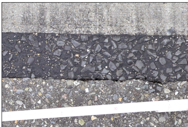
Bild 59: Große Ablösungen zum Asphalt auf der Bundesstraße B 14 nach 5 Jahren unter Verkehr (1)
