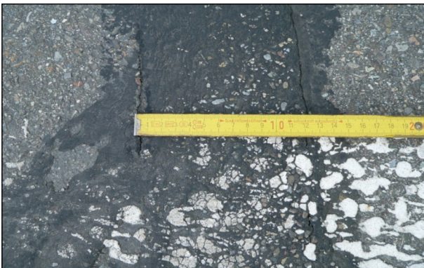
Bild 73: Ablösungen zwischen Belagsdehnfuge und Asphalt nach 9 Jahren unter Verkehr (1)
