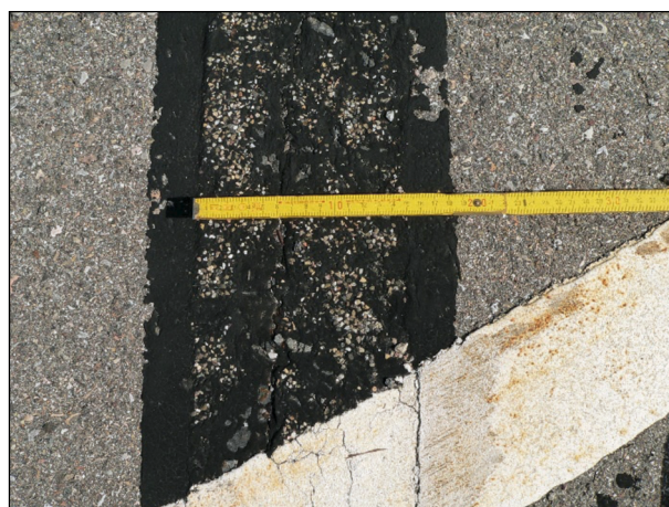
Bild 80: Belagsdehnfuge am Anschlussast bei Gaiss mit oberflächennahen Rissen nach 4 Jahren unter Verkehr (1)
