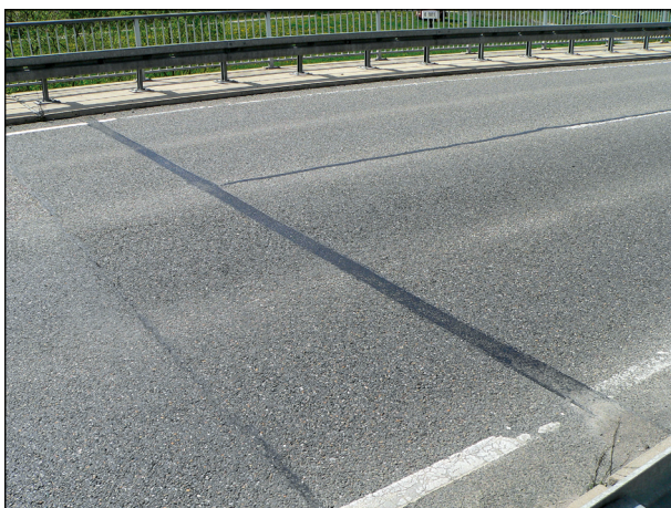
Bild 51: 12 cm breite Belagsdehnfuge auf der Brennerstraße nach 1 Jahr unter Verkehr ohne Schäden (1)
