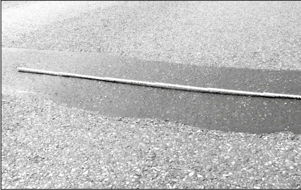
Bild 38: 50 cm breiter Fahrbahnübergang aus Asphalt mit Spurrinnen (1)
