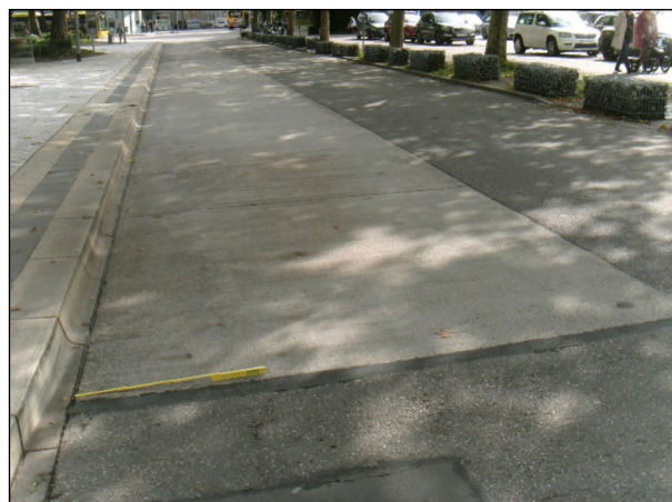
Bild 99: Belagsdehnfuge nach 7 Jahren unter Verkehr, mit ca. 60 cm langen Ablösung am Übergang zum Beton (12)
