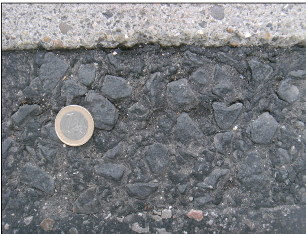
Bild 102: Freigelegte grobe Gesteinskörnung der Muldenfüllung (12)
