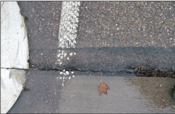
Bild 108: Enthaltungen zur Betonfahrbahn im nicht überfahrenen Bereich (13)
