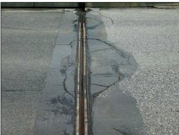
Bild 7: Belagsschäden entlang eines Fahrbahnübergangs aus Stahl (14)
