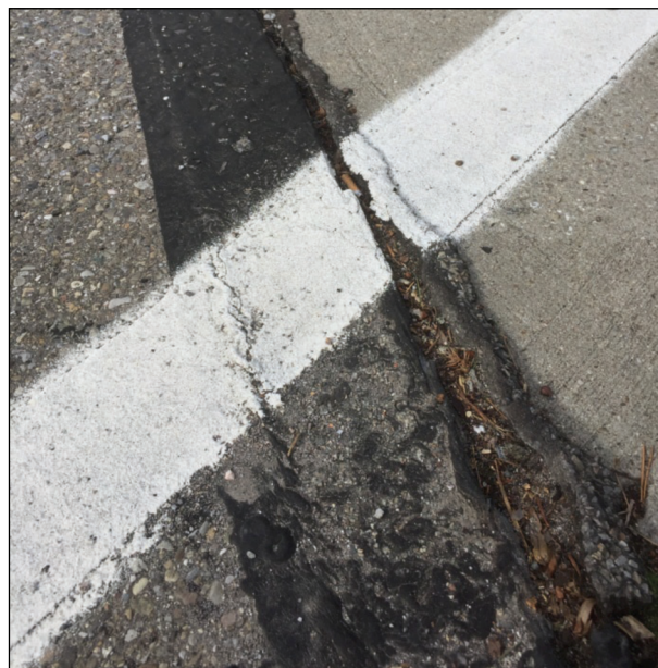
Bild 91: Belagsdehnfuge mit Verdrückungen und Flankenabrissen nach 9 Jahren unter Verkehr (8)
