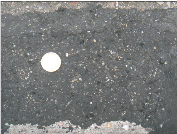
Bild 101: Versprödung und oberflächliche Risse (12)
