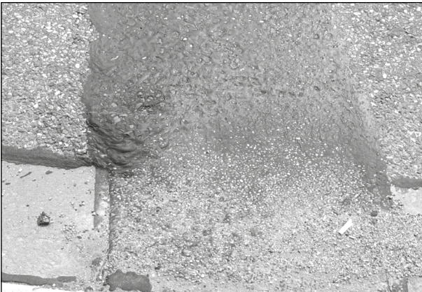
Bild 39: Verwalkungen am Fahrbahnrand (1)
