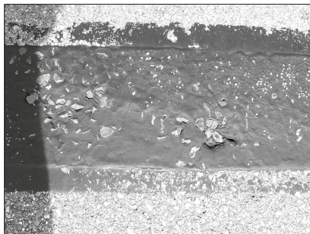
Bild 78: Freigelegte grobe Gesteinskörnung in der Rollspur der Belagsdehnfuge bei Waldkirch nach 4 Jahren unter Verkehr (1)
