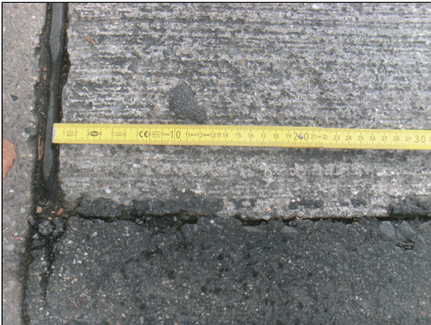
Bild 100: Ablösungen am Übergang zum Beton (12)
