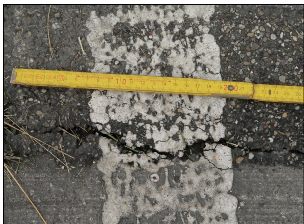
Bild 67: Riss an der Grenzfläche zum Beton am Abzweig Fahrtrichtung Rottweil nach 7 Jahren unter Verkehr (1)
