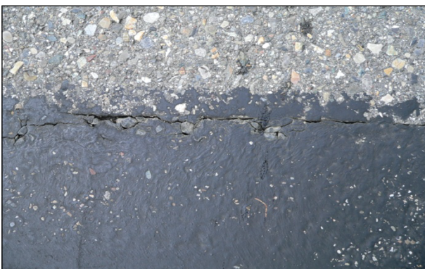
Bild 74: Ablösungen zwischen Belagsdehnfuge und Asphalt nach 9 Jahren unter Verkehr (1)
