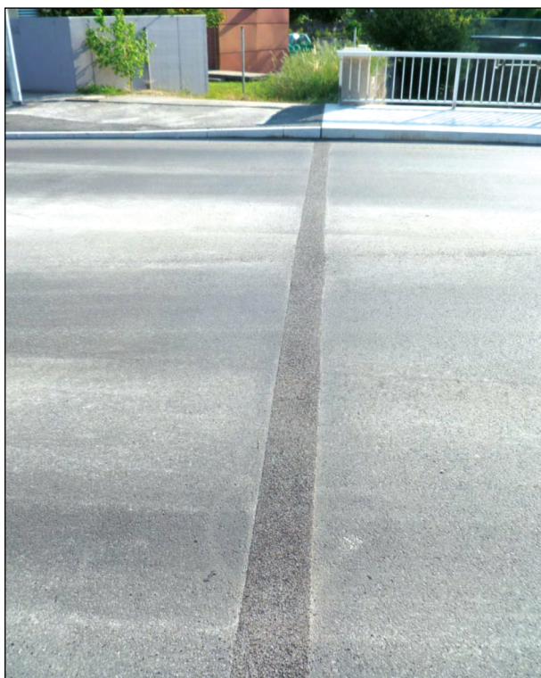
Bild 44: Belagsdehnfuge bei Fertigstellung in 2012 (4)
