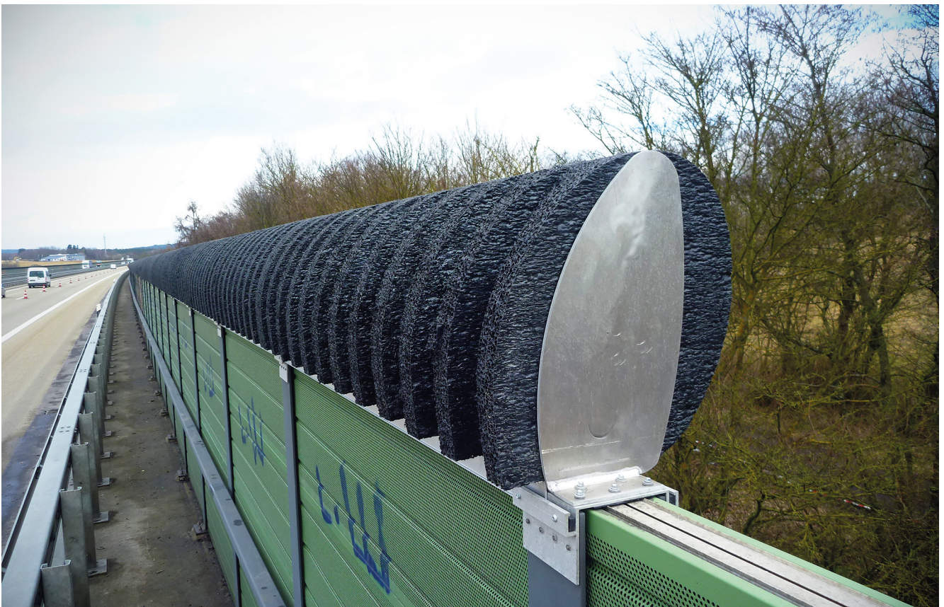
Lärmindernder Aufsatz aus Flüsterschaum auf einer Lärmschutzwand (Bild: Andre Jaborek, Hessen Mobil)
