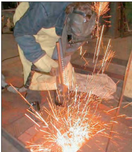
Bild 94: Reparaturschweißen eines Großgussteils im vorgewärmten Zustand im Wärmebehandlungsofen (Bild: C. Hahn, Remscheid)
