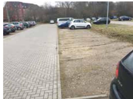
Bild 46: Parkplatz mit einer Fahrbahn aus Beton-Rechteckpflaster. Befestigung der Stellplätze mit einer „wassergebundenen Wegedecke“
