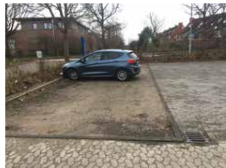
Bild 47: Schadhafte Deckschicht einer wassergebundenen Decke
