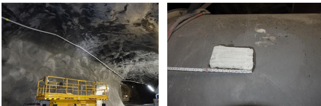
Abbildung 13 Ehemaliges Testgelände mit schwarzen Brandrussresten (links) und Probenahmeort WP-1 am Gehäuse des Entrauchungsventilators (rechts)
