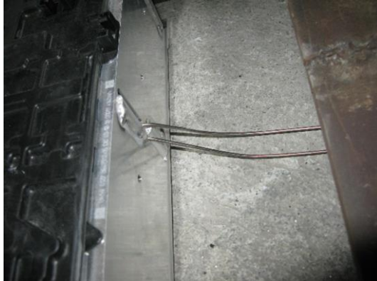
Abbildung 31 Zwei Mantelthermoelemente mit Messspitze im Zentrum des Batteriemodules
